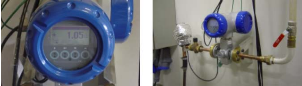
Figura 26: Medidor de vazão.
