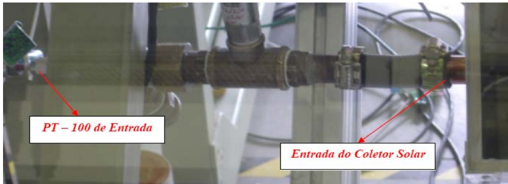
Figura 23: Sensor de temperatura na entrada do coletor solar.
